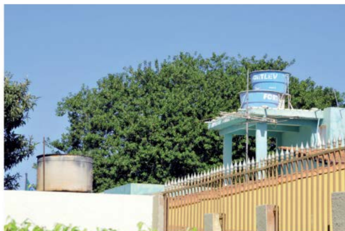
Figura 2. Ejemplos de depósitos de agua elevado (grupo A1). Este tipo de depósito se encuentra ligado a la red pública o al sistema de captación mecánica en pozo o cisterna. Fuente: MSB 2015.
